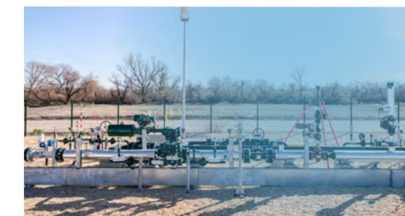
Jupiter 1000 : premier démonstrateur industriel français permettant de transformer l'énergie électrique renouvelable en gaz de synthèse (Power to Gas).
